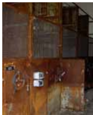
Interiör av transformatorbyggnad.
