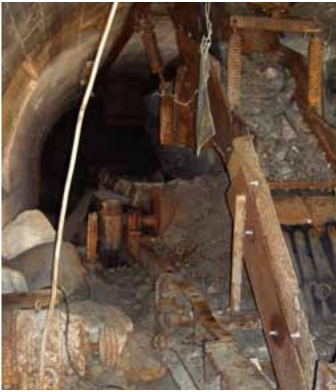
Lastningsanordningar i södra betongorten under malmupplaget.
