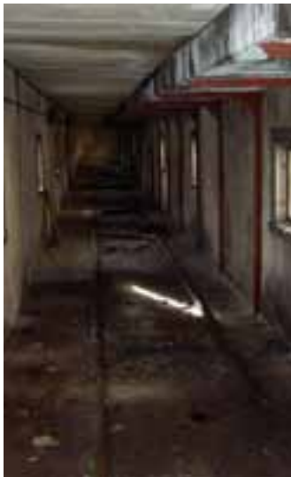
Interiör av bandgångshus vid sligutlastning.
